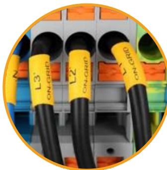
MARCAJELE SPECIALE ALE CABLURILOR DIN CUTII DE COMBINARE ATSE
